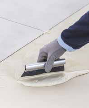
Auftragen von planeo Klebstoff SafeBond und Verklebung von LVT mit breiten Fugen und Fugenkreuzen
